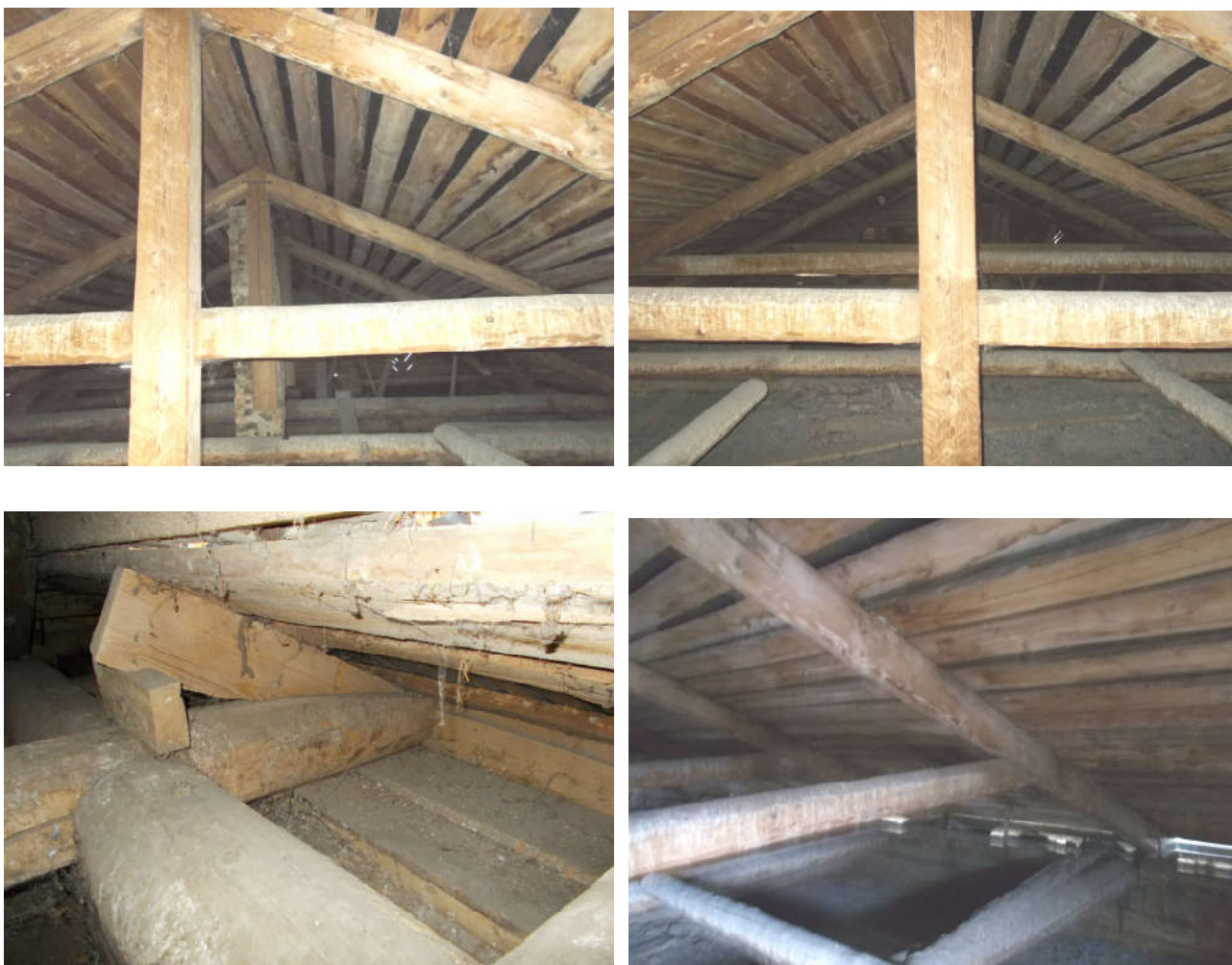
Фото 4.1. 7 Стропильная конструкция кровли. Следы повсеместного замачивания стропильных ног, обрешетки. Деформация опорной части балки навесной стропильной ноги
