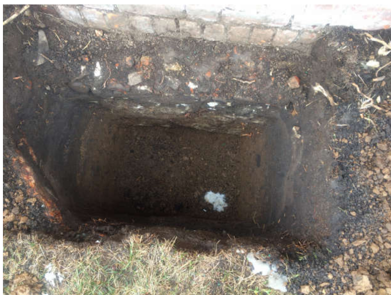
Фото 4.1. 13 Шурф № 1 конструкций фундаментов. Фундаменты выполнены из щебня известковых пород, уложенных на известковом растворе. Глубина заложения фундамента от поверхности земли 1150мм ширина подошвы 890мм. Трещин, вымывания раствора не выявлено.
