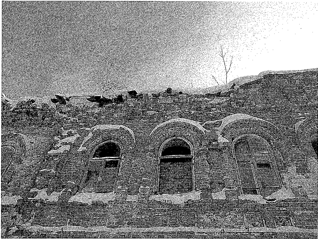
Фото 5. Поросль на кровле, выпадение кирпича.
